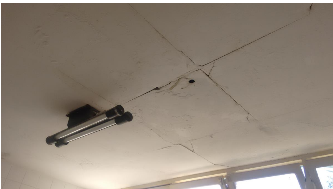
Forro do banheiro do Auditório
